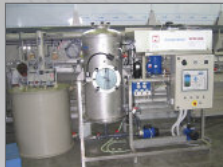
Vakuumverdampfer zur Abwasservermeidung
