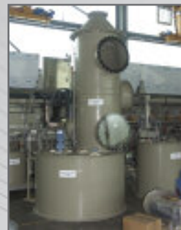
Waschsystem zur Abluftreinigung
